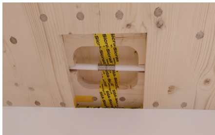
Abbildung 5 Kopplungspunkt des Heizkreislaufes an der Deckenunterseite
