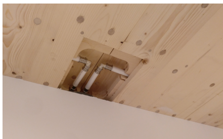
Abbildung 6 Kopplungspunkte Vor- und Rücklauf von einem Heizkreislauf an die Anbindungsleitung an der Deckenunterseite
